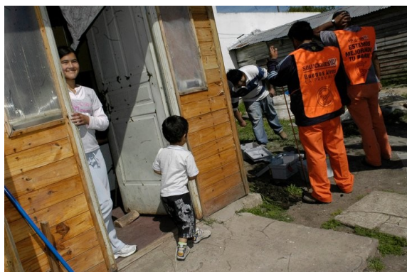
Figura 5: “Los kokitos” junto a alumnos instalando los tableros sociales. Se puede apreciar el momento en que se predisponen al hincado de la jabalina de puesta a tierra de protección.
