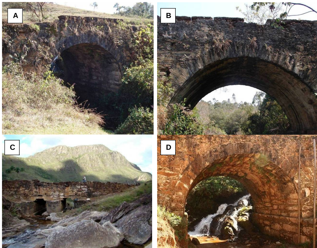
Figura 3- a) Ponte da Rancharia; b) Ponte da Caveira; c) Ponte do Calixto; d) Ponte do Falcão.
